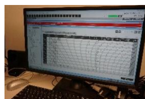
(1) 電気使用量計測モニター
