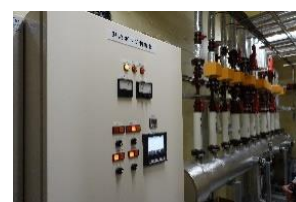
(4) 温泉水ポンプ制御盤
