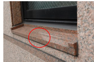
窓台の汚れ防止対策
