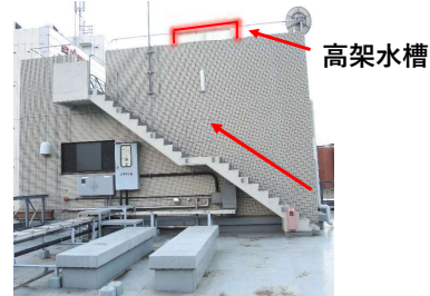
写真3-37 高架水槽への階段（安全な昇降）
